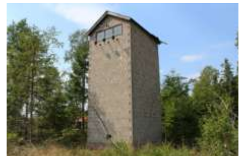
Vid Vekhyttan östra gården 3 finns detta transformator torn av betonghålstén som vittnar om hur bygden fick elektricitet.
